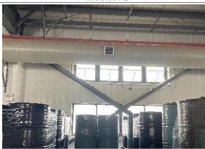
废气收集设施
