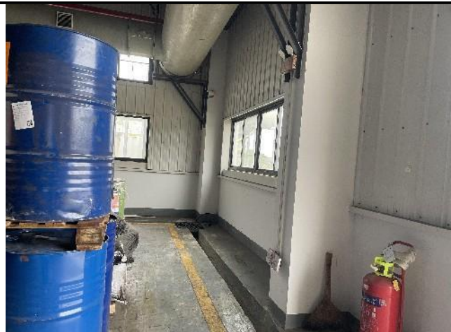
泄漏收集设施
